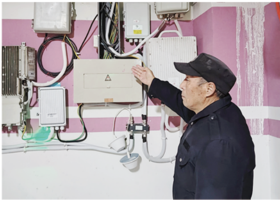
奎文区榕树苑小区地下停车场内新布设安装的通信设备。
