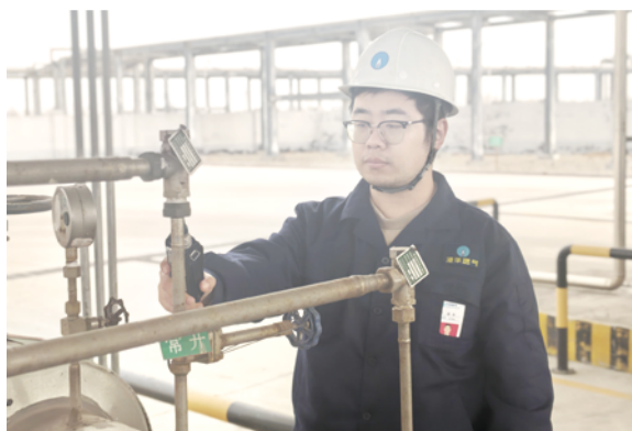
潍坊港华工作人员在滨海LNG应急调峰储配站对气设备进行测漏检查。
