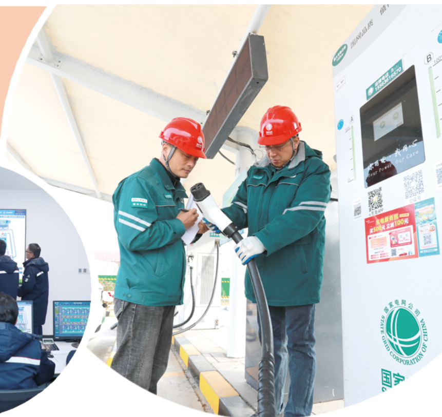
国网潍坊供电公司工作人员对青银高速高密服务区充电站进行巡检。
