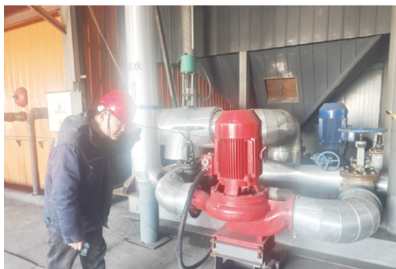
潍坊港华热力有限公司热源厂工作人员对供热设备进行巡检。
